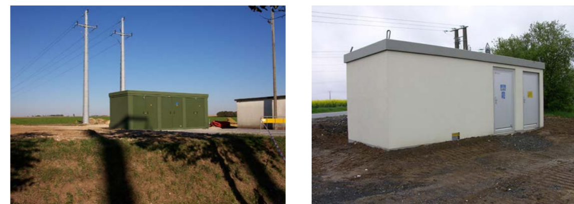
Photographie 1 : Exemples de postes de livraison
