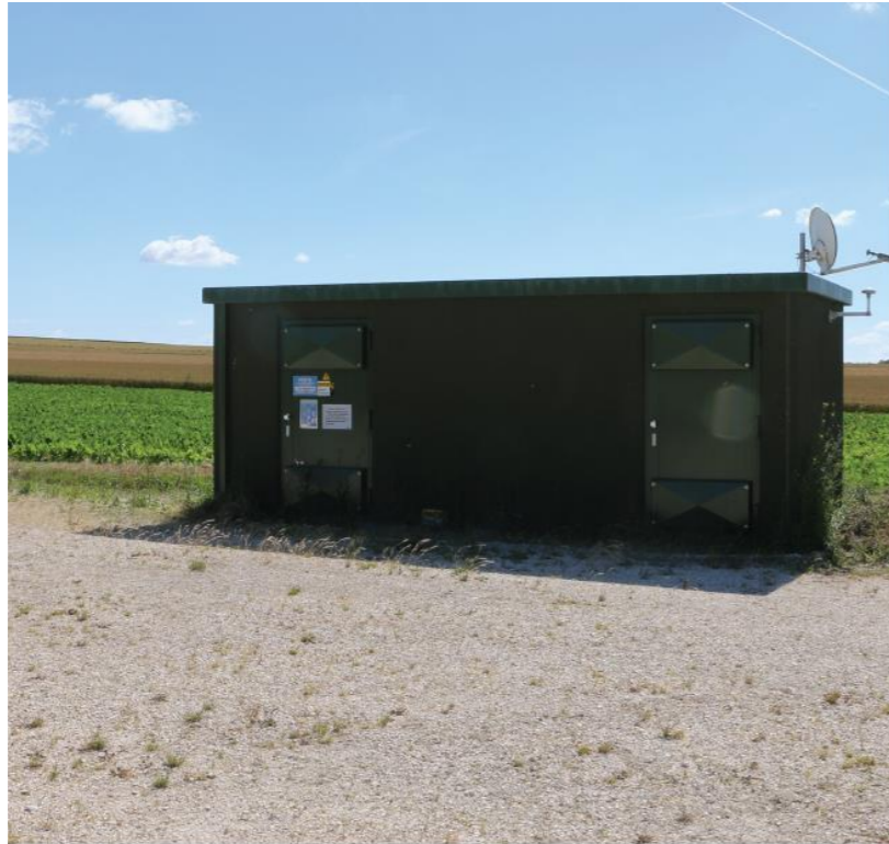
Figure 13 : Exemple de poste de livraison envisagé (source : Ater Environnement, 2021)
