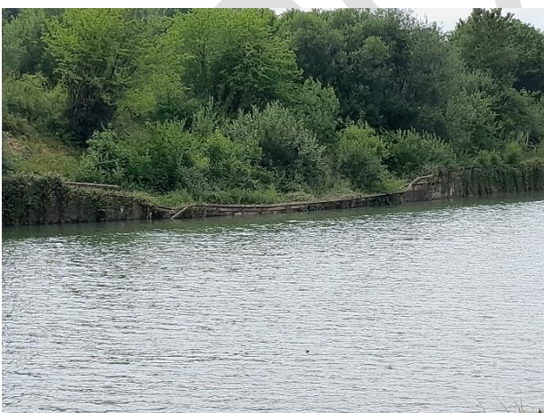
Berges béton dégradée
