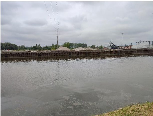
Berge de type palplanche métallique
