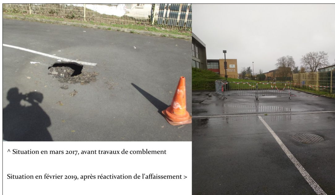
Figure III.23: Affaissement au niveau du parking de l'IRSTS. Source: mairie d'Arras et AGR.
