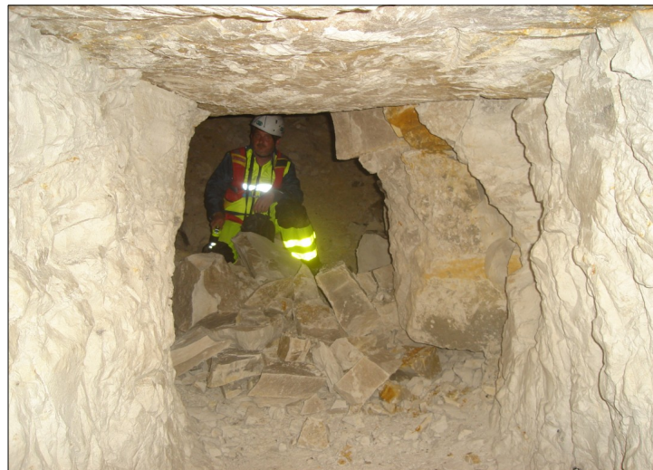
Figure III.5: Effondrement du toit (rue des Hochettes - Arras)
