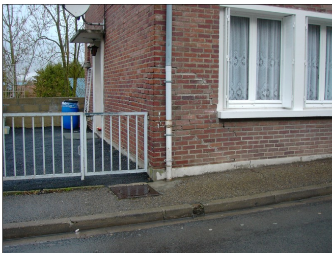
Figure III.4: Tassement sur terrains sous-cavés à Montdidier
