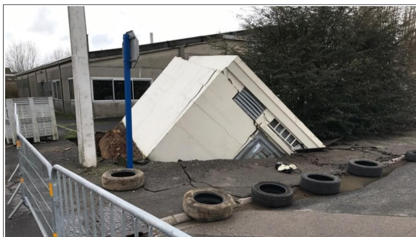
Figure III.6: Engloutissement d'un transformateur EDF à Beaurains (février 2018)
