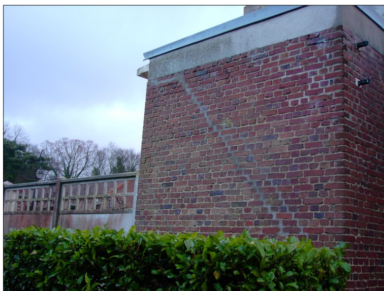
Figure III.3: Tassement différentiel au-dessus d'une carrière de craie à Montdidier
