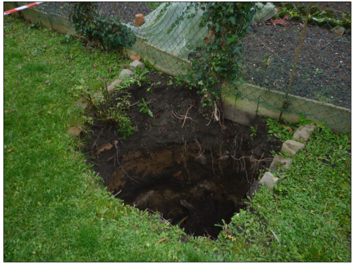
Figure III.7: Rupture d'une tête d'un ancien puits obstrué (Arras- 62, rue Gustave-Colin)
