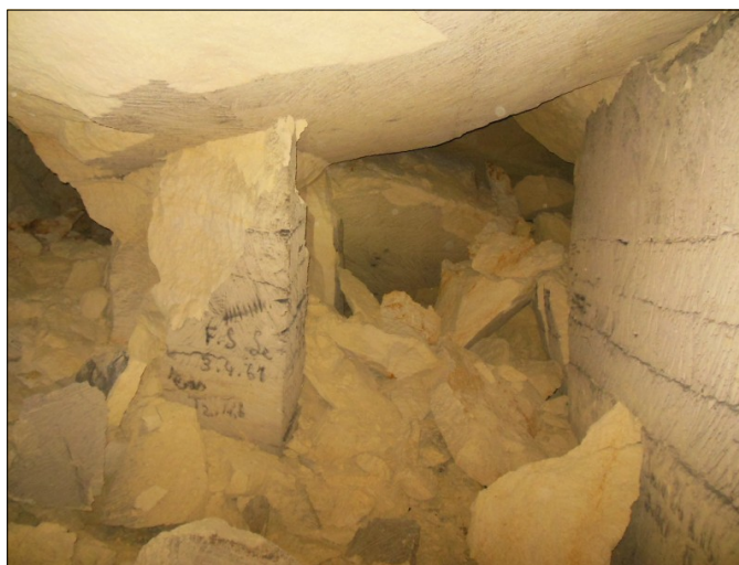
Figure III.8: Éclatement d'un pilier et affaissement du toit (Saint-Même-les-Carières)
