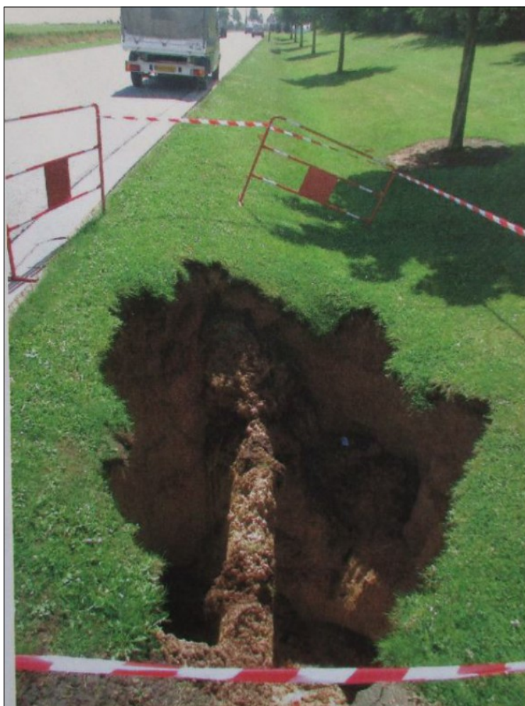
Figure III.18: Fontis le long de la chaussée du barreau sud. Source: Mairie d'Arras (ARR296)
