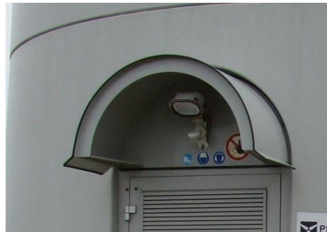
Entrée d'éolienne avec spot à détection de présence
