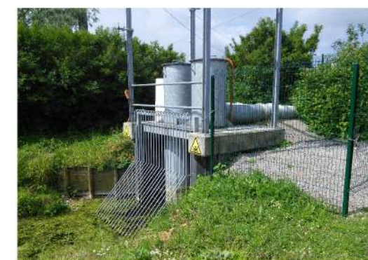
Station de pompage Ferme Potez ou Marais de Guînes (3)
