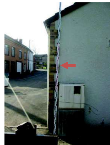
Figure 4 : niveau d'eau atteint aux toilettes publiques (repère n°4 sur la carte)
