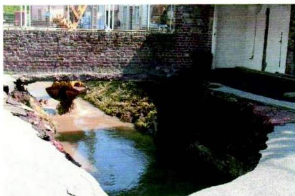
Figure 1 : voute du passage busé de la Nave effondrée en 2005 (cf. carte : repère n°2)
