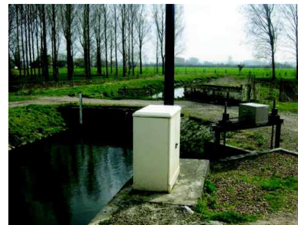
Figure 4 : Grand Nocq à Bellerive et vanne de délestage dans la Clarence (cf. carte : repère n°1)
