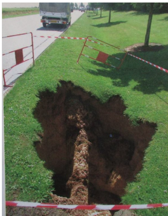
Figure II.8: Fontis le long de la chaussée du barreau sud. Source: Mairie d'Arras (ARR296)
