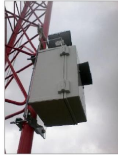
Figure 230 : Batcorder sur le mât de mesures (source : AXECO, 2017)
