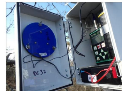
Figure 228 : Boîtier d'enregistrement autonome (source : AXECO)
