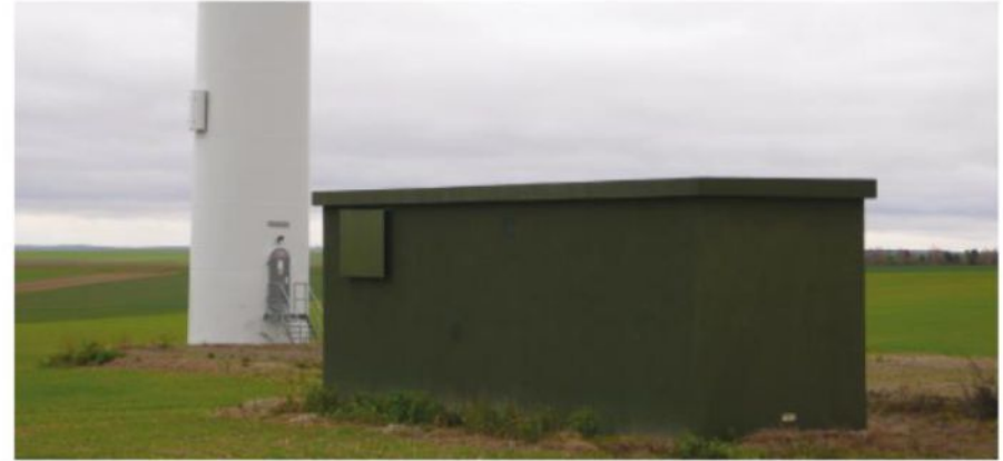
Figure 186 : Exemple de poste de livraison de couleur adapté au contexte paysager (source : EPURE, 2017)
