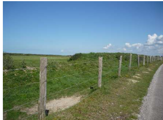
Illustration 35: Irrégularités dans la digue Taaf à proximité du quartier des Escardines - 2015
