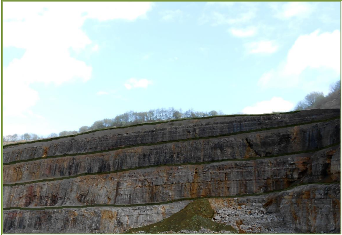
Vue des fronts de taille et cône d'éboulis en végétalisation libre au sein de la carrière
