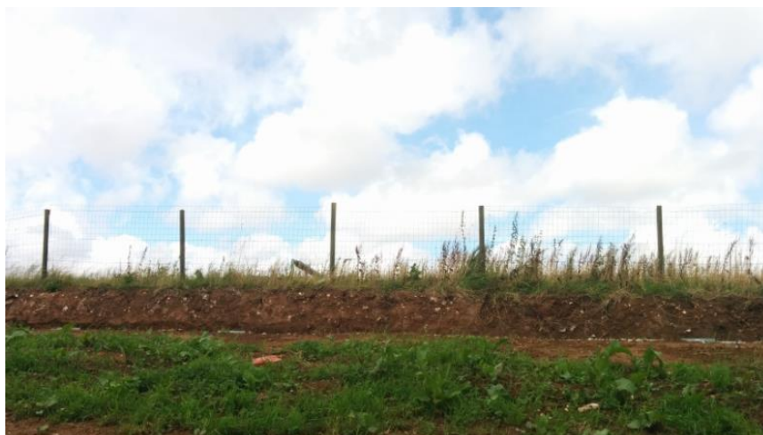
Figure 24 : Filet anti-envol installé sur le CVD de Bimont
