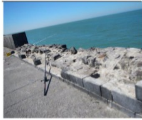
Arrachement du parapet maçonné sous l'assaut des vagues
