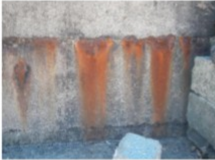
Traces de corrosions (coulures)
