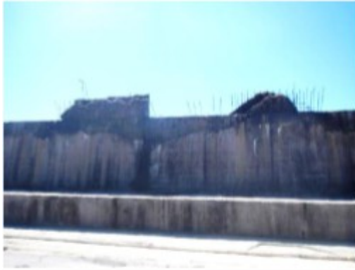
Arrachement ou enlèvement de la partie supérieure des murs chasse mer
