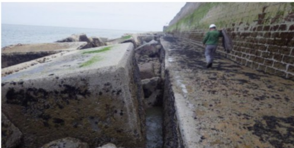
Glissement des blocs de carapace / cavités potentielles en pied de risberme
