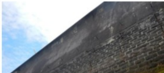
Présence de réservations et de fers corrodés saillants
