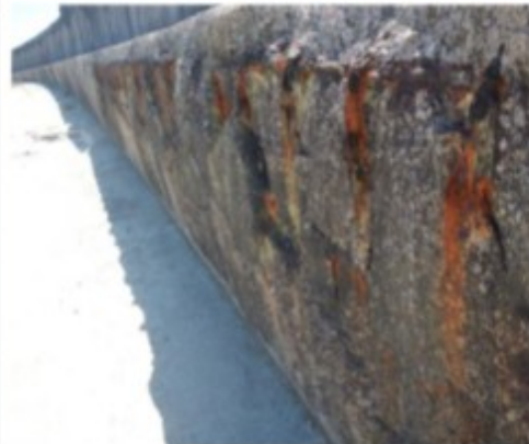
Parapet : épaufrures avec aciers corrodés apparents
