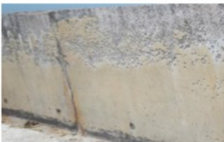
Fissures traversantes verticales du parapet
