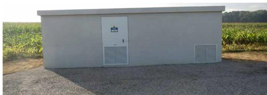
Figure 177 : Illustration d'un poste de livraison (source : Epure, 2015)
