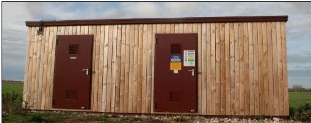
Exemple-type de poste de livraison
